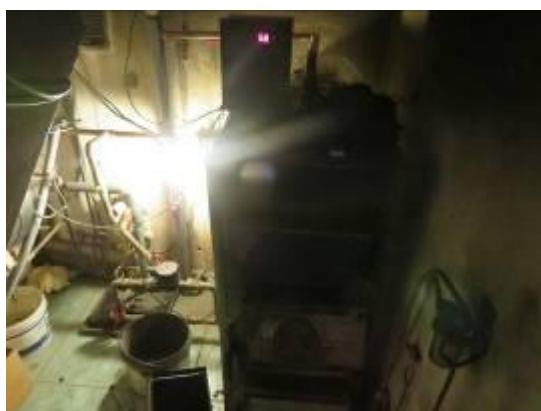
Budynek nr 2 kotłownia.
