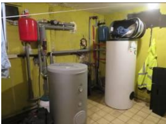
Budynek nr 1 kotłownia.
